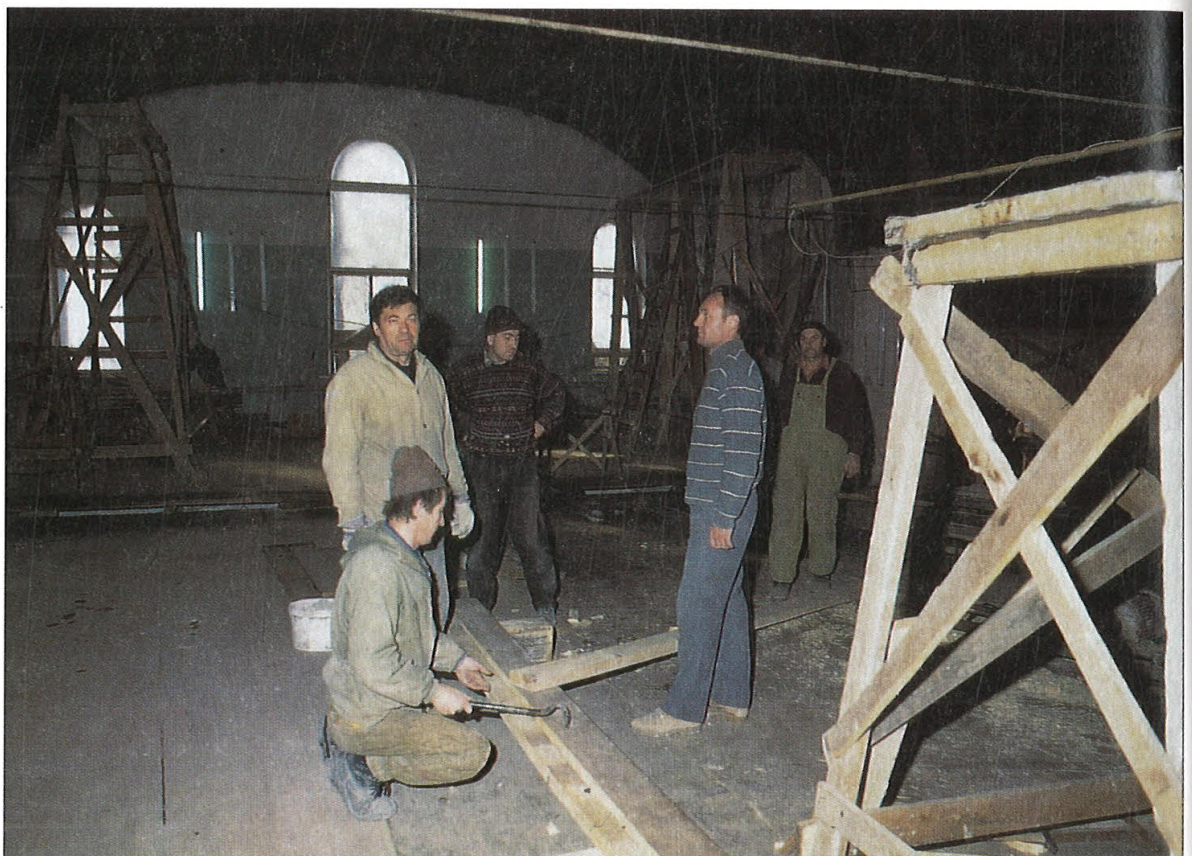
36. На стройке: некоторые сильно повреждённые балки деревянной конструкции пришлось заменить
