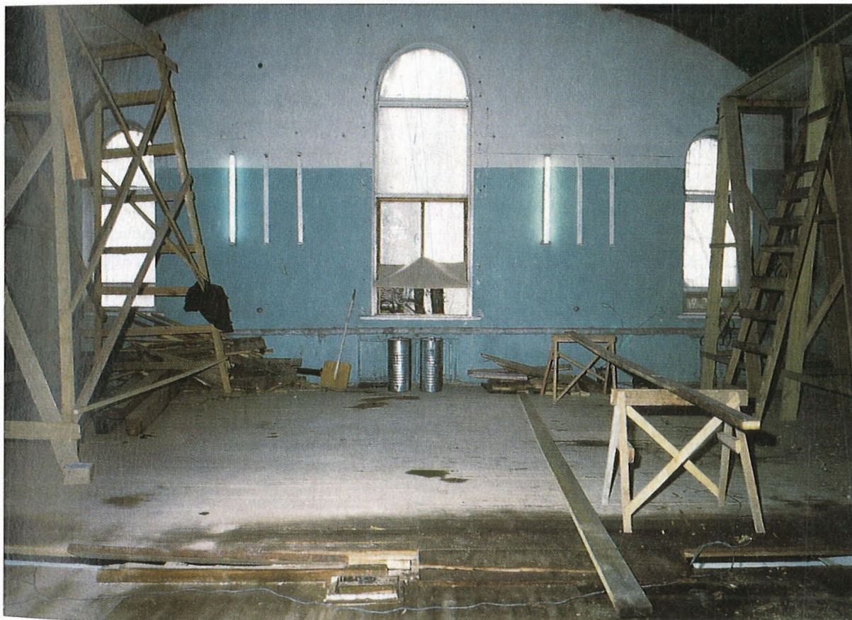
37. На стройке: окна в торцевой стене апсиды перед снятием межэтажного перекрытия, которое было встроено во всём помещении Музея
